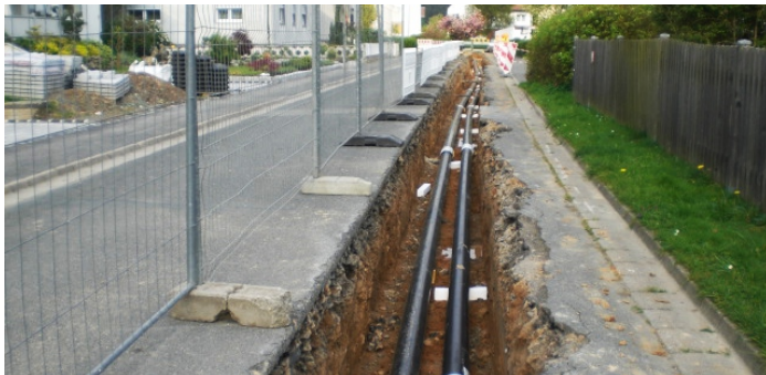
Vor- und Rücklauf eines Nahwärmenetzes
